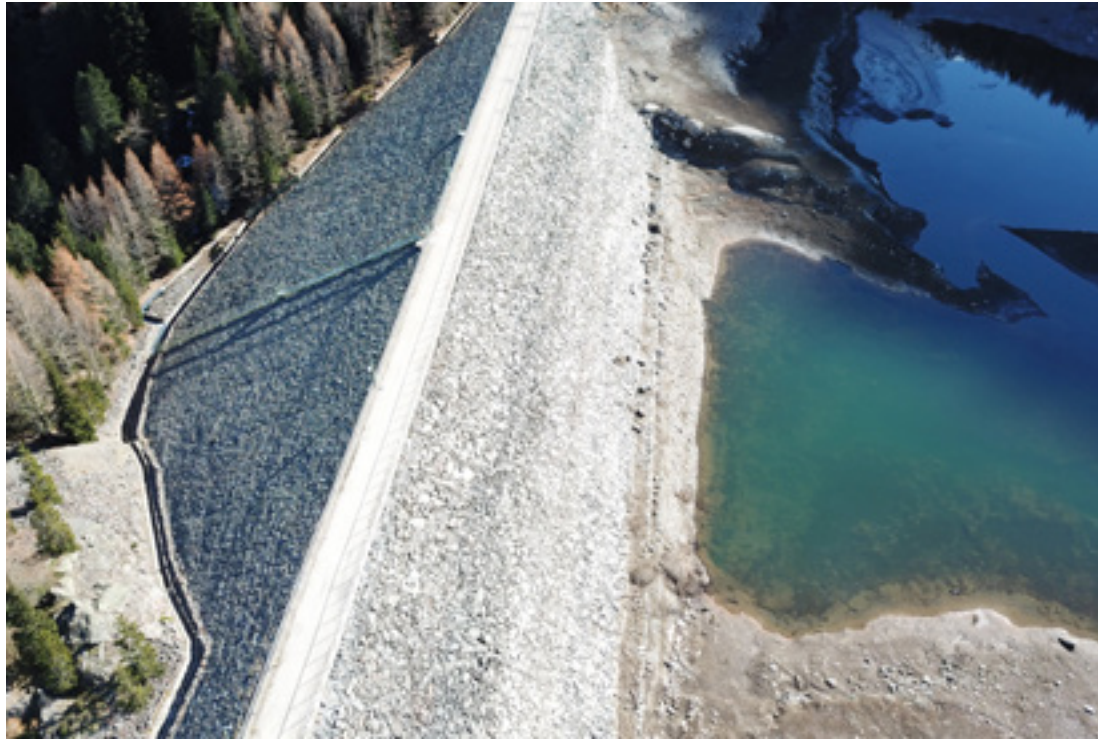
Grazie all'uso dei droni è possibile ispezionare in modo più efficiente parti degli impianti normalmente poco accessibili, tra cui condotte forzate o dighe, come quella di Fontana Bianca ritratta nella foto qui sopra.
