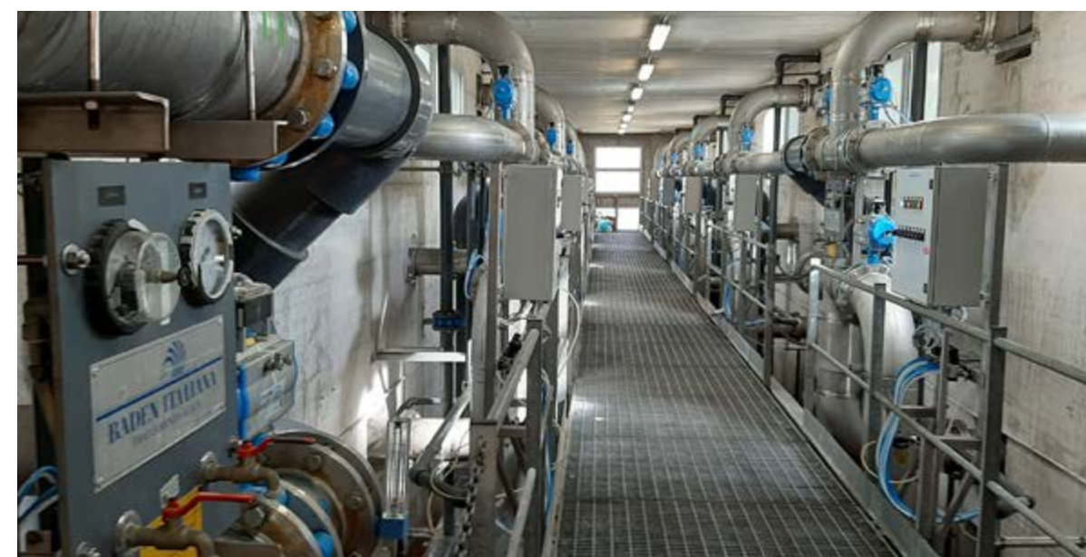
acquavenete / Sistema di filtrazione presso centrale di Alimascio, Longo
