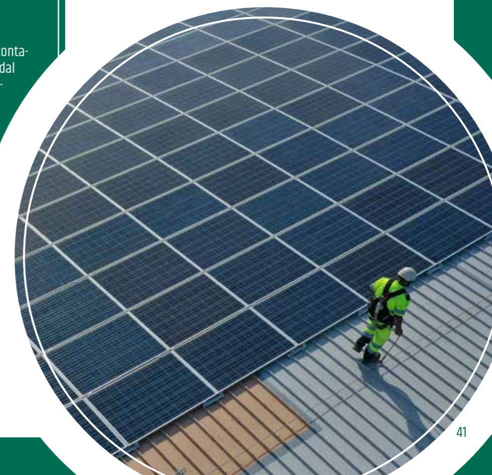
Foto: Impianto fotovoltaico A4 Galleria Fonica Cinisello Balsamo
